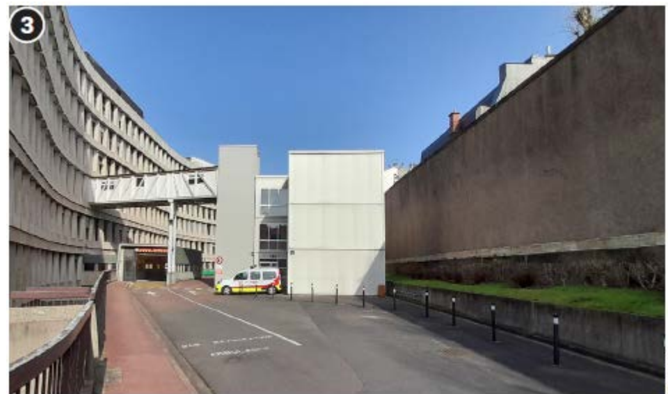
Mur de soutènement, partie est, d'une hauteur de près de 9 mètres (APUR)
