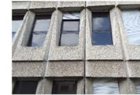
Joint de dilatation et caisson de volet roulant pouvant être utilisés par les pipistrelles
